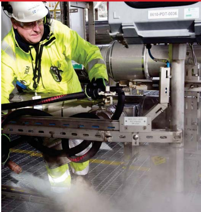
■ Gutten i røyken. Lars Skov Olsen sjekker kjøleanlegget.
